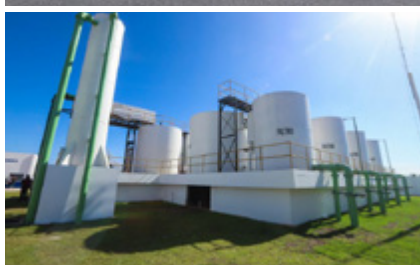
Sistema automatizado de captação de água do rio Moju
